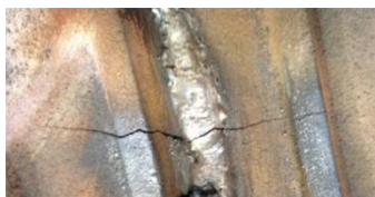
Рисунок 1 – Трещина в сваренной чугунной детали
